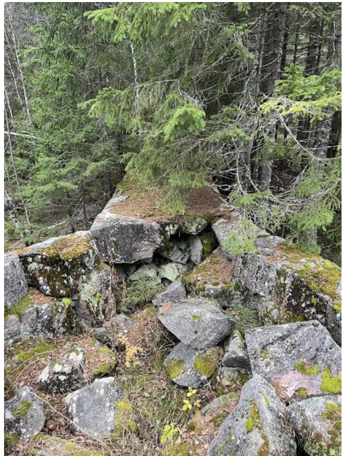
Figur 14: Ved Nummerdammen er det tydelige tegn på forfall i damkonstruksjonen. Foto: Larvik kommune
