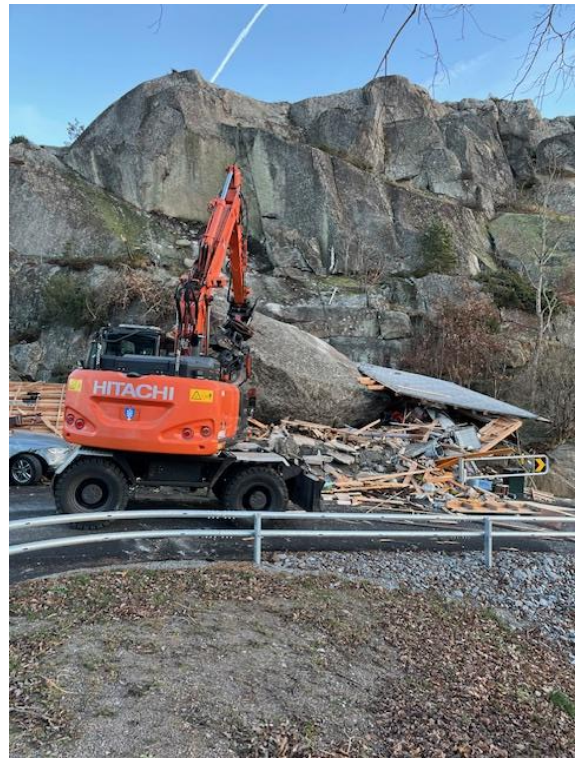
FIGUR 22: BLOKKFALL FRA SIGNALEN I STAVERN 2024. (KILDE: LARVIK KOMMUNE)
