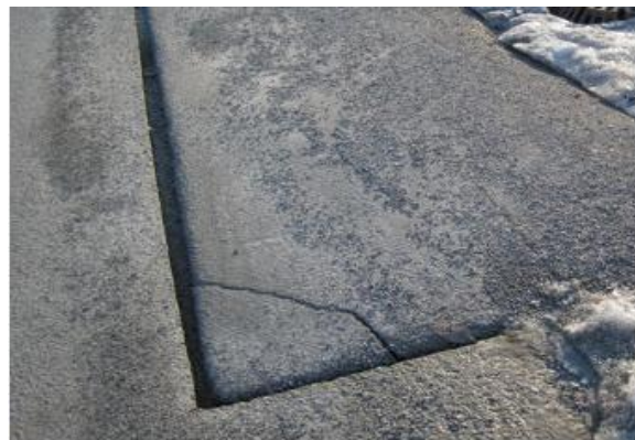
Figur 17 Uriktig utført asfaltskjøt uten fortanning
