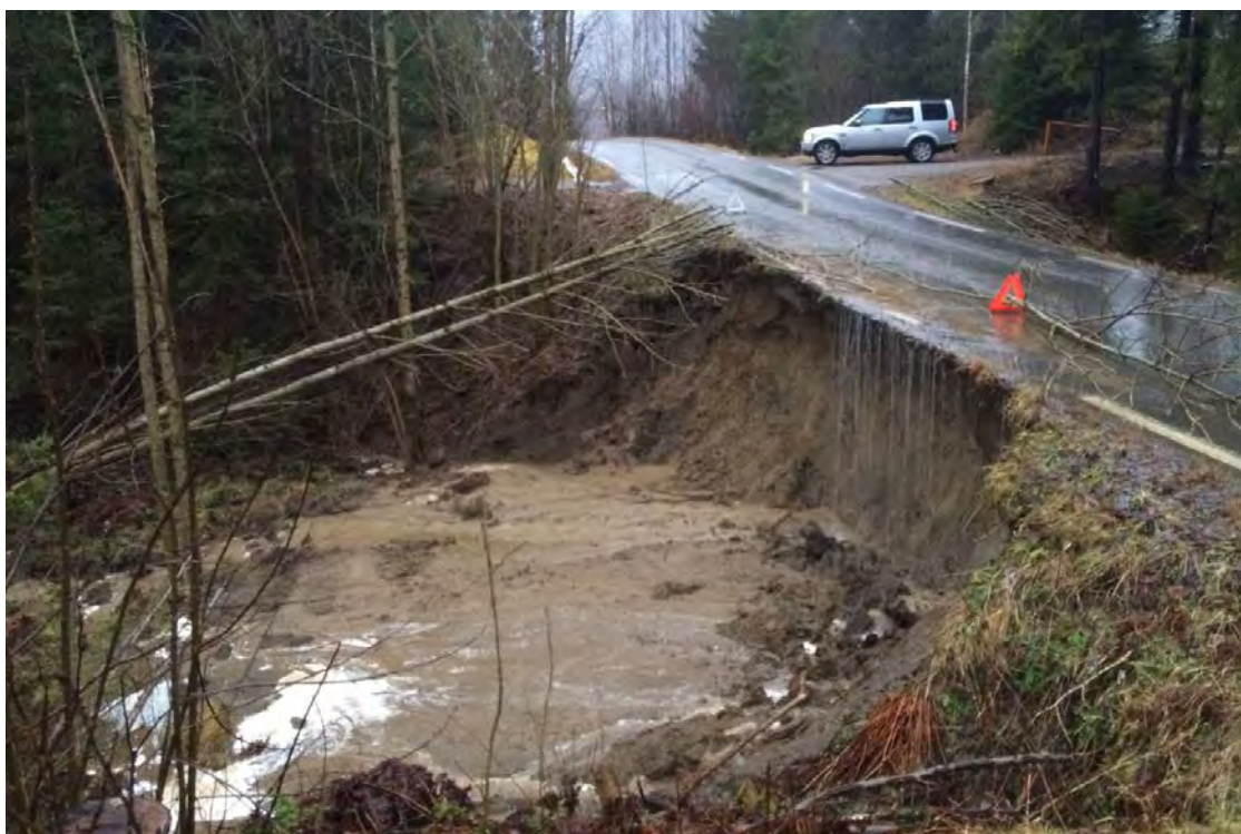
Skred ved Hedrumveien i Larvik, 24.12.2013 (Østlands-Posten, foto Knut Utklev).
