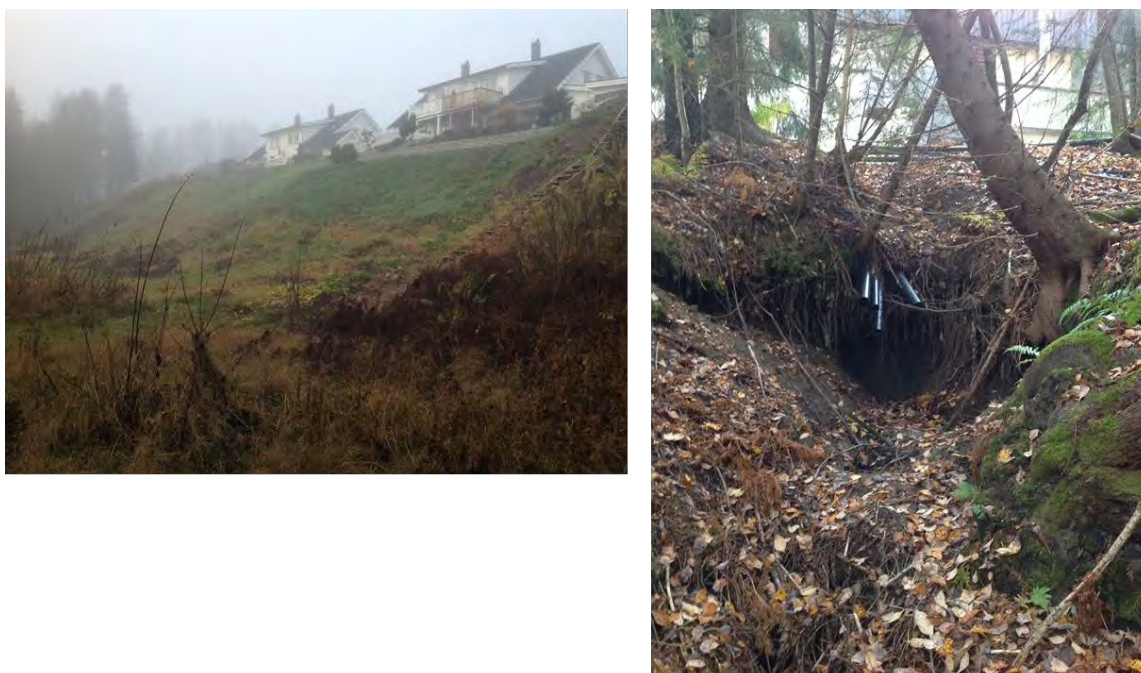
Figur 4-15: Venstre: Terrasse skråning ved Hukesletta boligfelt. Det ble observert noe sig på toppen av skråningen. Høyre: Erosjon som følge av lekkasje fra vannledning/avløpsnett.
