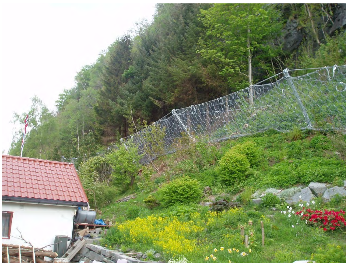
Figur 4-32: Eksempel på steinsprangnett satt opp ovenfor eksisterende bebyggelse (NGI-arkiv).
