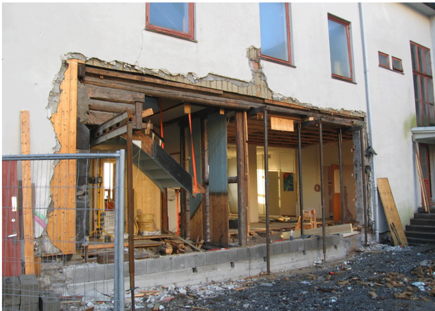
Manglende konstruksjoner: Ny grunnmur måtte støpes og deler av vegg måtte erstattes nord på patrisierdel.
