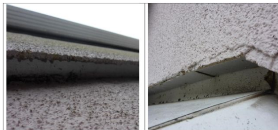
Figur 60. Foto tatt under befaring 2022-10-26 av profilsystem i underkant av isolasjonssjiktet. Foto til venstre viser underkant ved sokkel på langvegg (nordvest), og foto til høyre viser underkant ved overgang til beslag ved trapp (nordøst).
