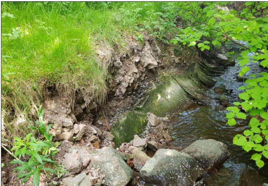
Bilde 1 Bildet er tatt i nordøstlig retning hvor fotograf står nord for Støperiveien 21. Bildet viser litt erosjon i yttersvingen av bekken. Foto: Sweco Norge AS.
