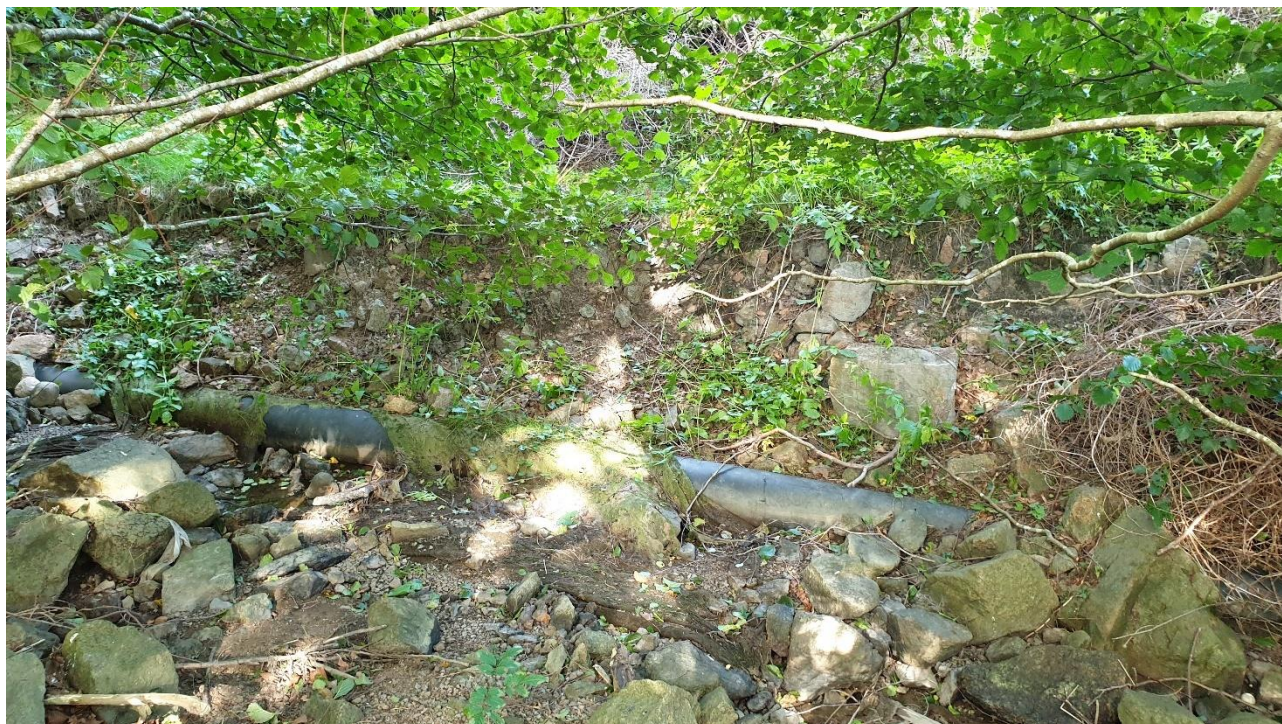
Figur 20 Erosjon rundt VA-rør oppstrøms Støperiveien.
