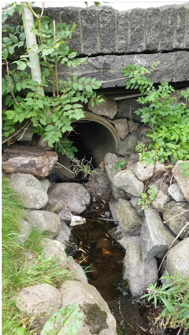
Figur 24 Innløp kulvert i hage oppstrøms Stavernveien. Innløpet er delvis tetta med velta stein og bør ryddes opp.
