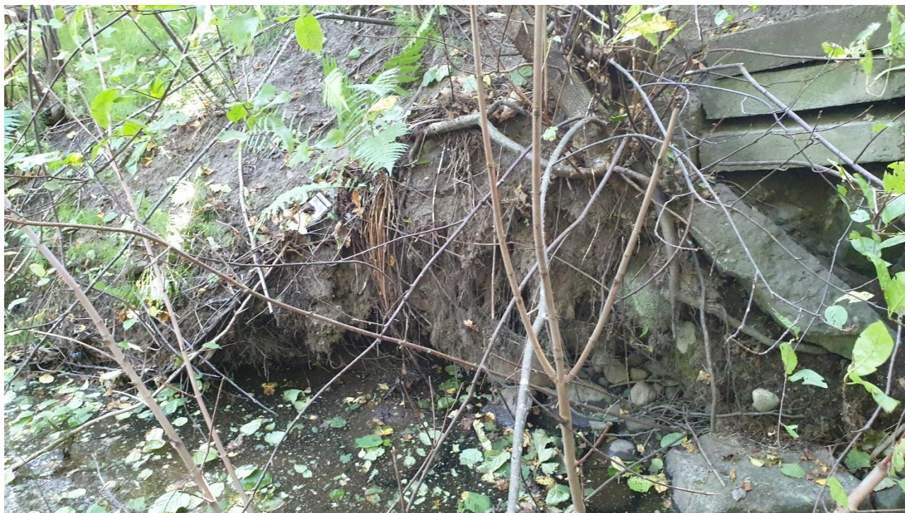
Figur 19 Utløp kulvert under Støperiveien. Tydelig undergraving av skråning.
