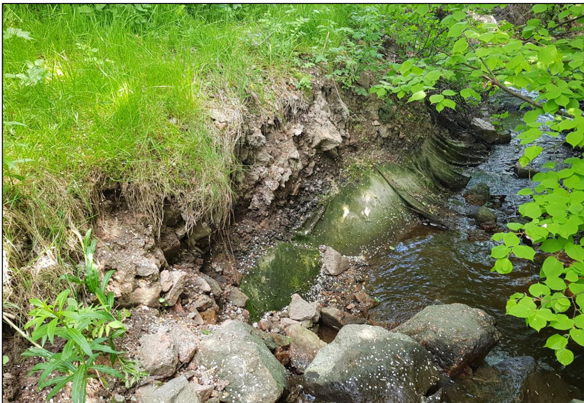
Bilde 1 Bildet er tatt i nordøstlig retning hvor fotograf står nord for Støperiveien 21. Bildet viser litt erosjon i yttersvingen av bekken. Kilde: Sweco Norge AS.
