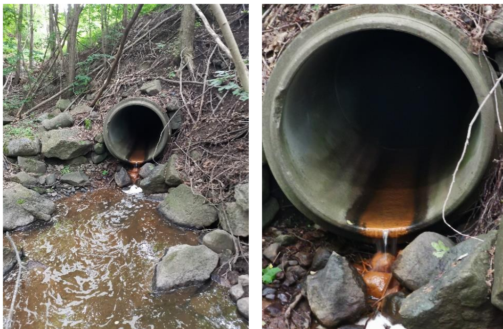
Figur 4-1. Kulvert under Stavernveien. Dette er vandringsstopp for sjøørreten. Foto: Sweco.
