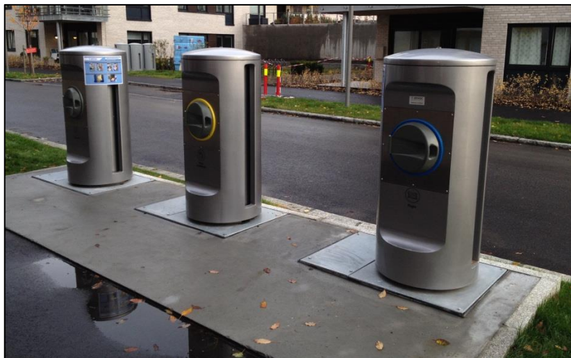
Figur 3-7: Nedkast til stasjonært avfallssug – 3 avfallstyper
