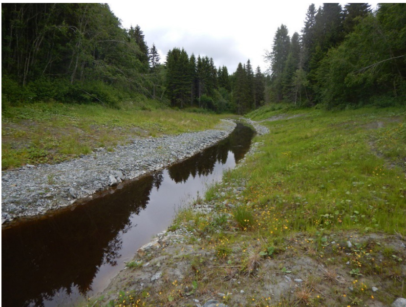
Figur 6.4 Motfylling og hevet bekkebunn i Klæbu i Trøndelag. Foto: Geir B. Hagen, NVE
