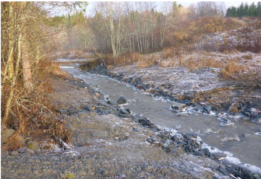
Figur 6.2 Erosjonssikring av Litl-elva i Namdalseid i Trøndelag. Foto: Geir B. Hagen, NVE
