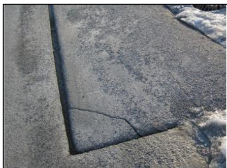
Uriktig utført asfaltskjøt uten fortanning
